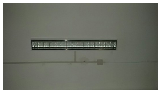
Figura 4.12 - Particolare dei corpi illuminanti ubicati nelle aule
