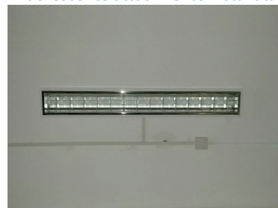
Figura 8.5 - Particolare di una lampada fluorescente attualmente installata
