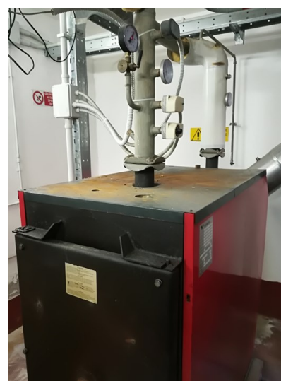
Figura 8.3 - Particolare del generatore di calore attuale
